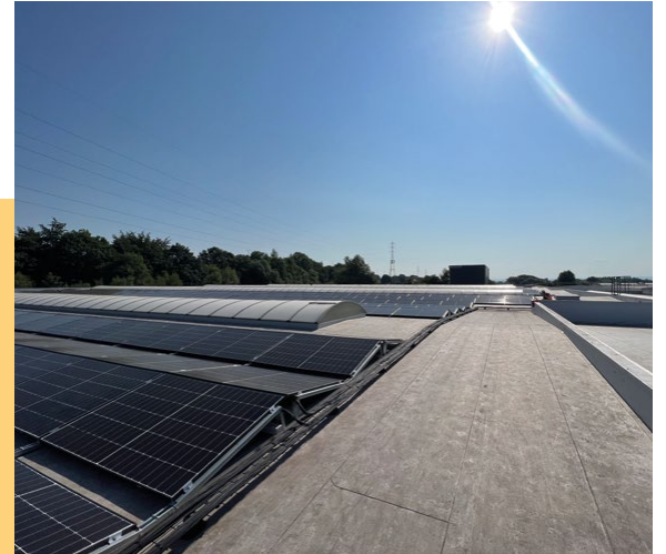
Les Ets Joskin équipés d'un système énergétique intégré comprenant 3800 panneaux photovoltaïques, 3 batteries de stockage et 26 points de recharge pour véhicules électriques.
