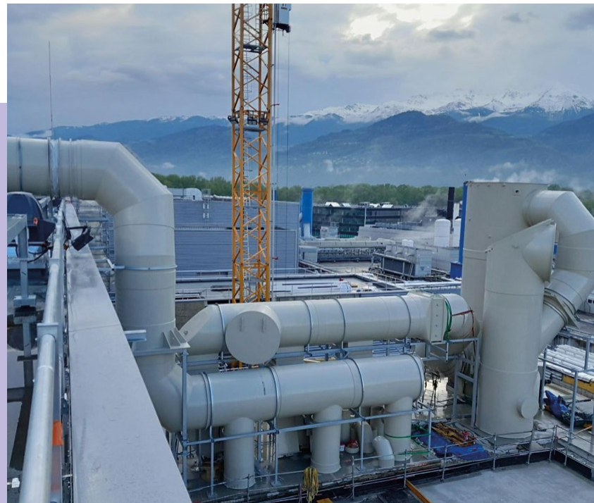
John Cockerill a fourni des laveurs de gaz pour traiter les rejets d'une nouvelle usine française d'un fabricant de semi-conducteurs.
