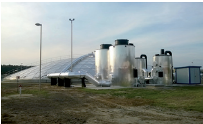
Stations d'épuration des eaux usées collectives
