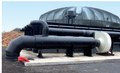
Stations d'épuration des eaux usées industrielles
