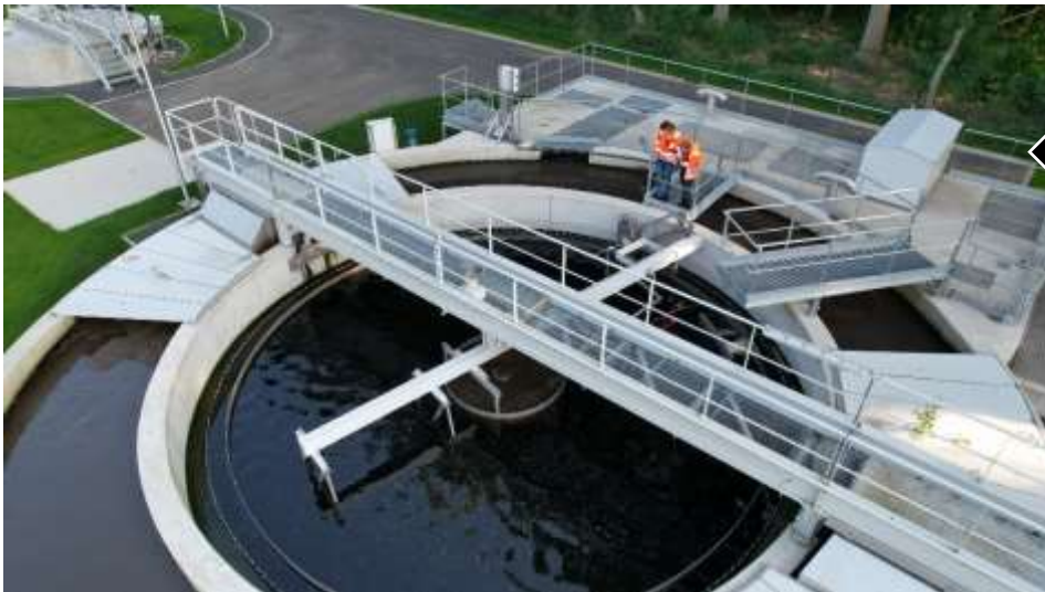
D'une capacité de 1 000 équivalent habitant, la station d'épuration prend en charge les eaux usées du sud de Templeuve (Belgique).
