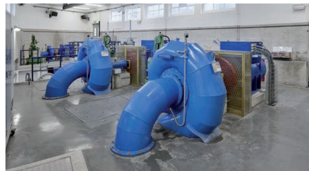
Centrale hydroélectrique, 2,3 MW (Eupen, Belgique)
