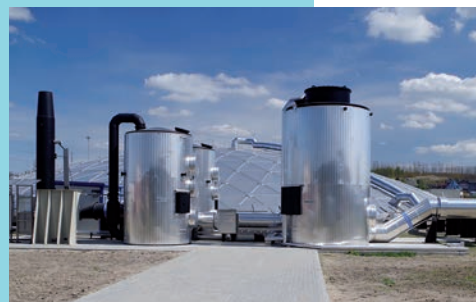
Traitement des odeurs en station d'épuration (installation calorifugée), 48 000 m 3 /h (Pologne)
