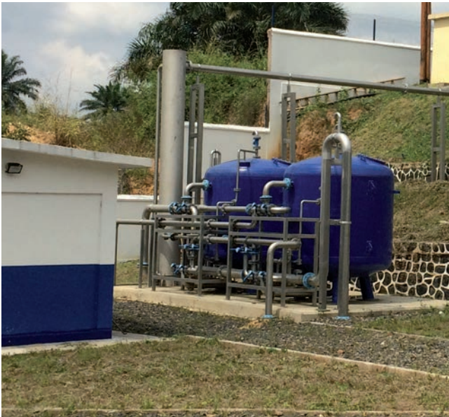
Station de traitement d'eau potable, 50 m 3 /h (Tonga, Cameroun)
