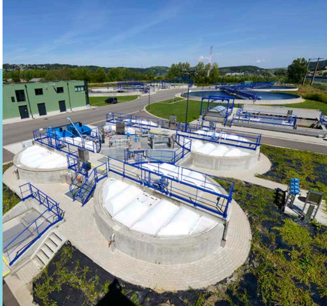
Station de traitement des eaux usées municipales, 54 000 EH (Amay, Belgique)
