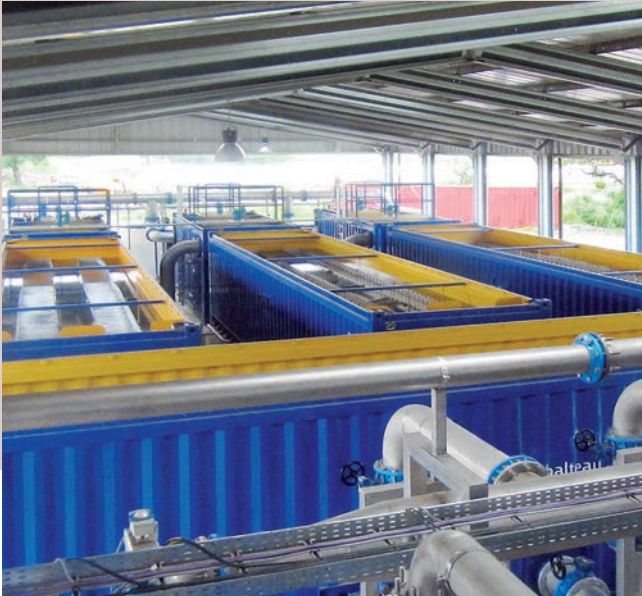
Station de traitement d'eau potable (unités conteneurisées), 750 m 3 /h (Kpong, Ghana)
