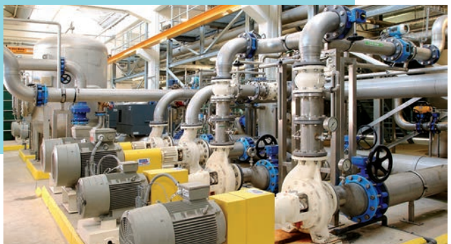
Station de traitement d'eau potable et station de pompage, 800 m 3 /h (Jambes, Belgique)
